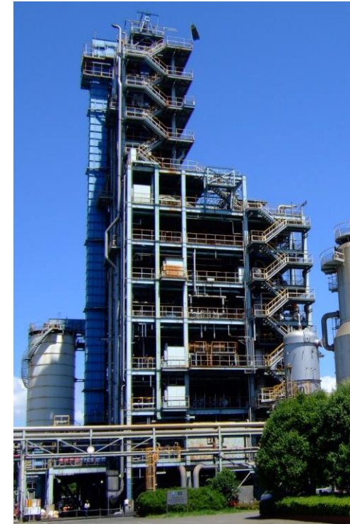
プラスチックケミカルリサイクル ガス化プラント
